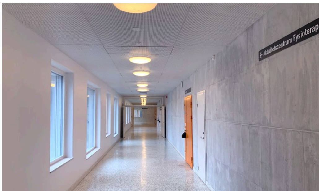
Fig. 44. Partier av förbindelsegången saknar installerad konst. Verksamhetsrepresentanten påpekar ett behov av att komplettera den befintliga kollektionen med ytterligare konstverk.
